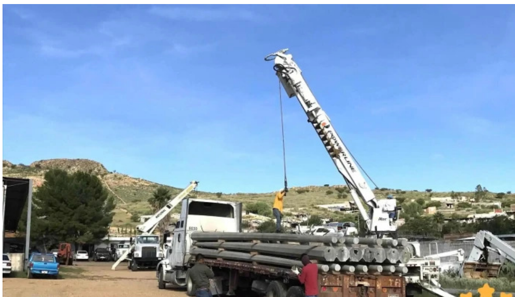
Powerline multiservicios del propietario
