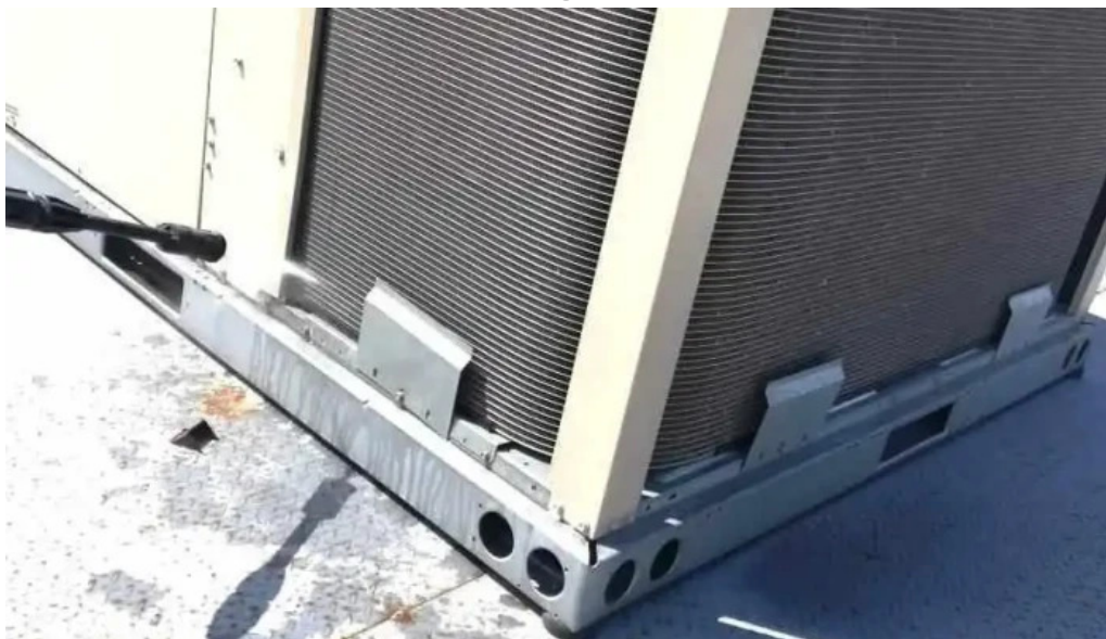
Mantenimiento y suministros electricos maquina
