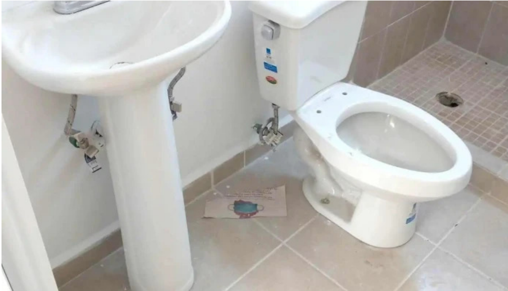
Plomeria y electricidad interior
