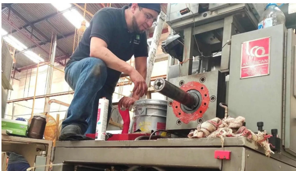
Plomeria y electricidad mendoza salto azcapotzalco ciudad de mexico
