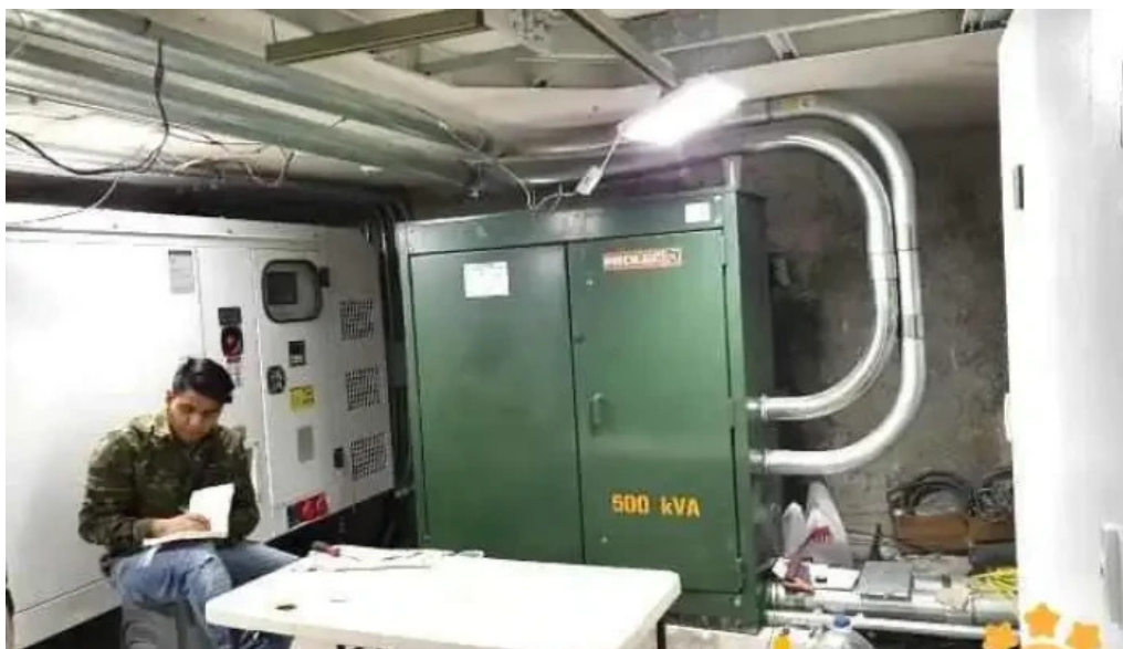
Instalacion electrica y sistemas de seguridad j c martinez interior
