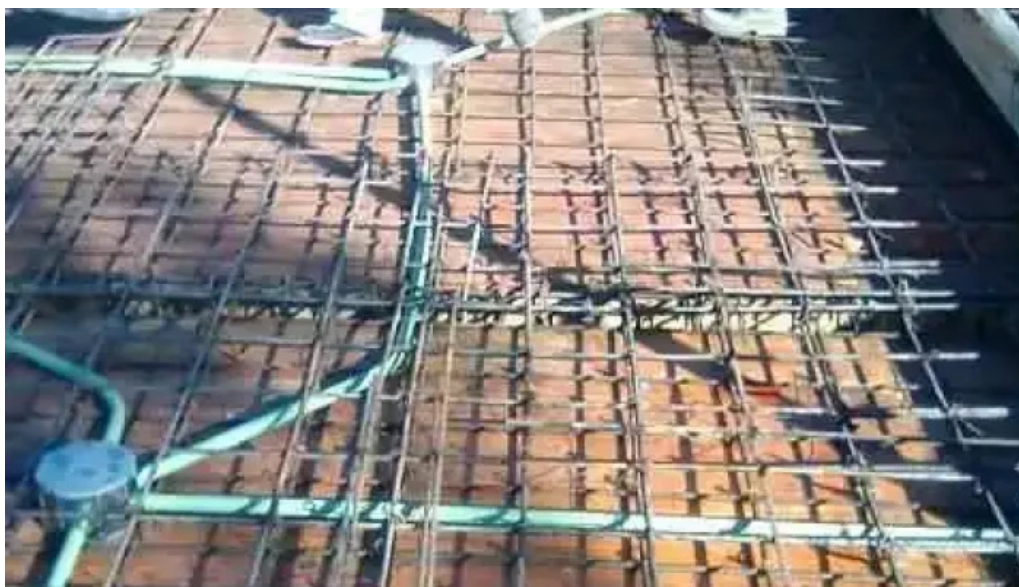
Instalacion electrica y sistemas de seguridad j c martinez del propietario
