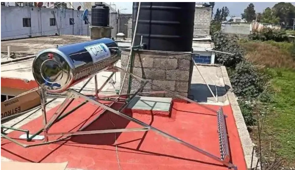
Mantenimiento electricidad cuauhtemoc ciudad de mexico
