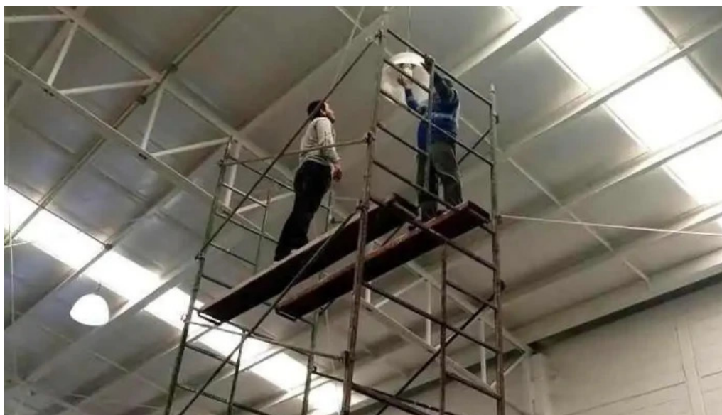
Servicios electricos de sinaloa culiacan rosales
