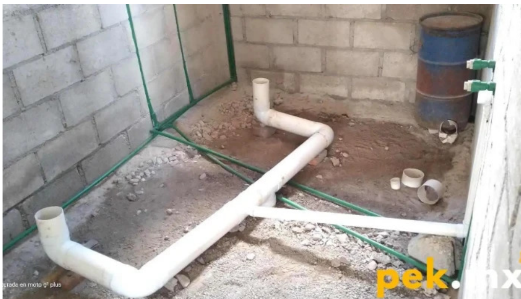
Plomería y electricidad el capulín
