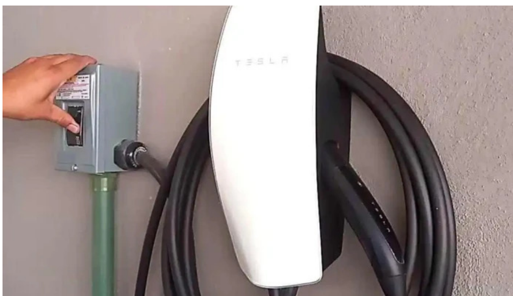
Electricista mantenimiento en general del propietario
