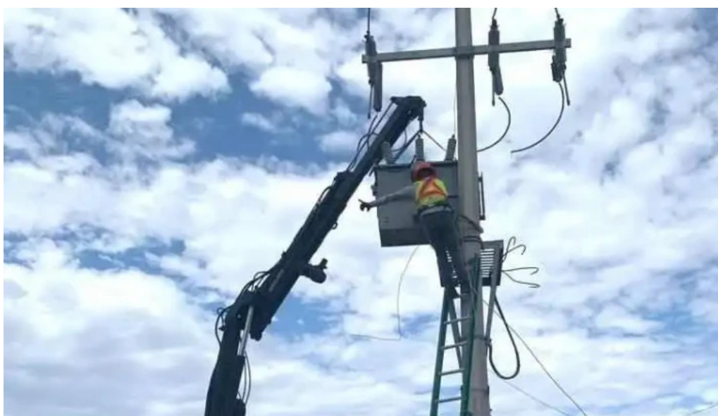
Instalaciones electricas ec instagram
