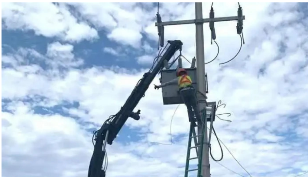
Instalaciones electricas ec los mochis
