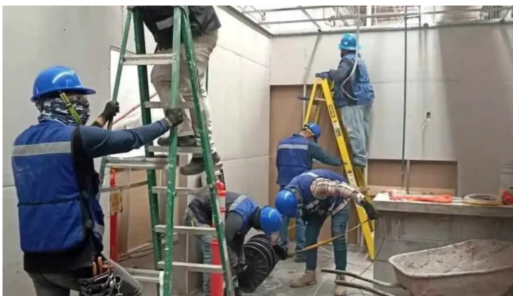
Instalaciones electricas comentarios
