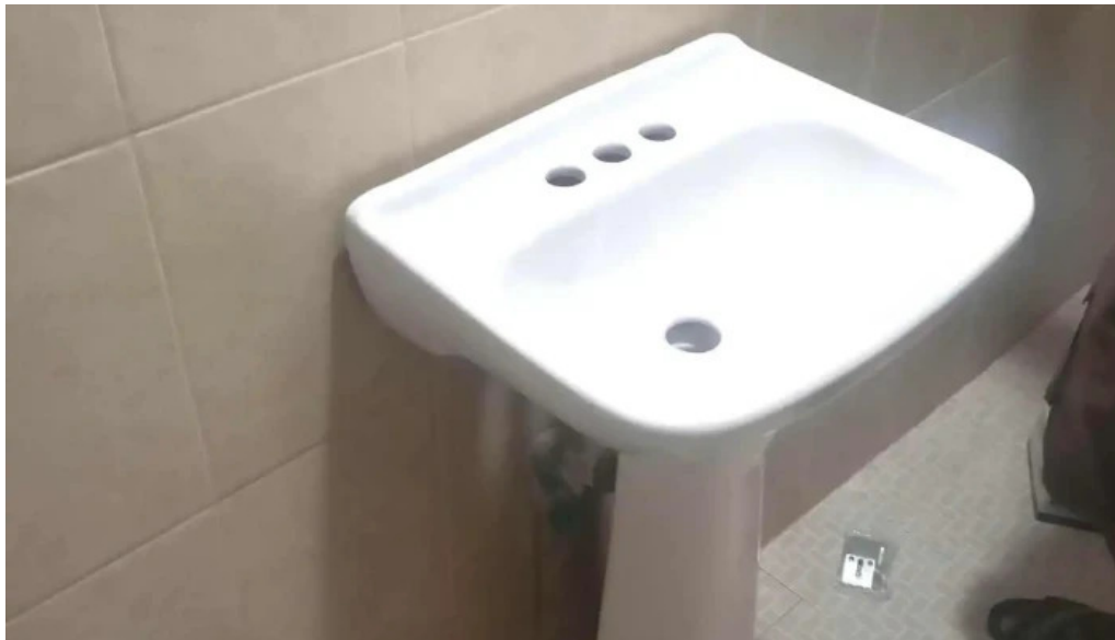
Electricidad y plomeria shadai interior
