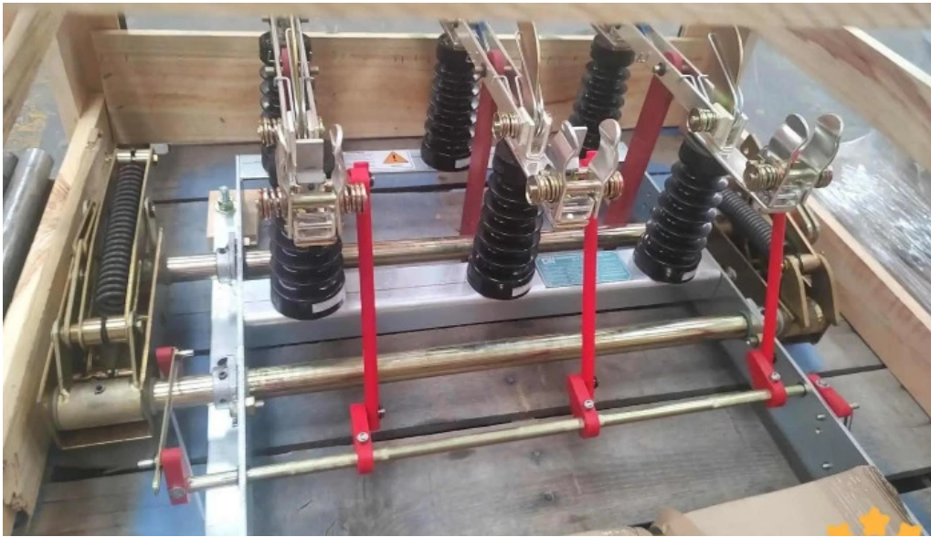
Electrica bermen sa de cv interior
