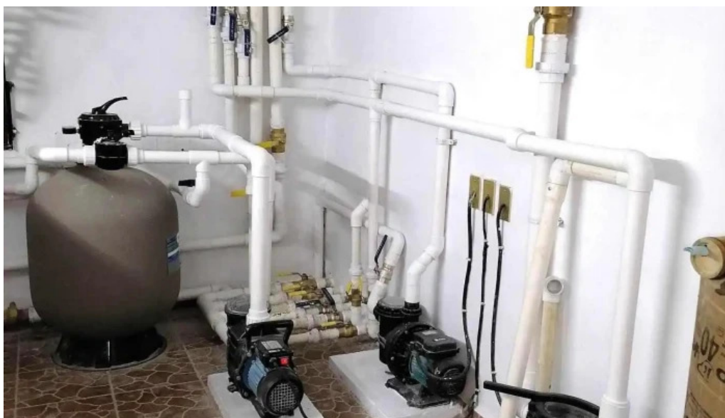
Servicios y mantenimiento ramos tuberia
