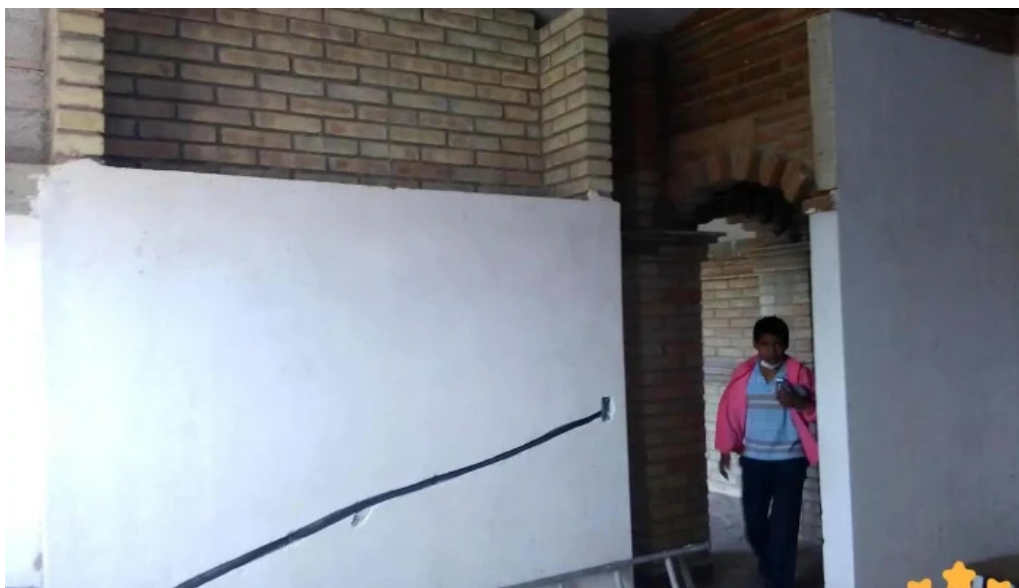
Plogalec plomeria gas electricidad del propietario
