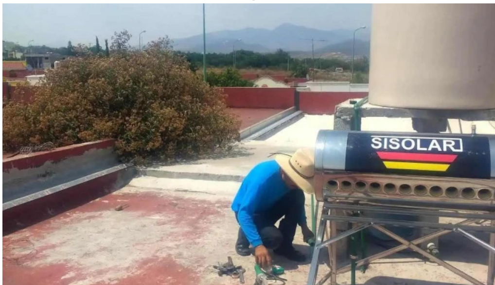
Plomeria uri tubería
