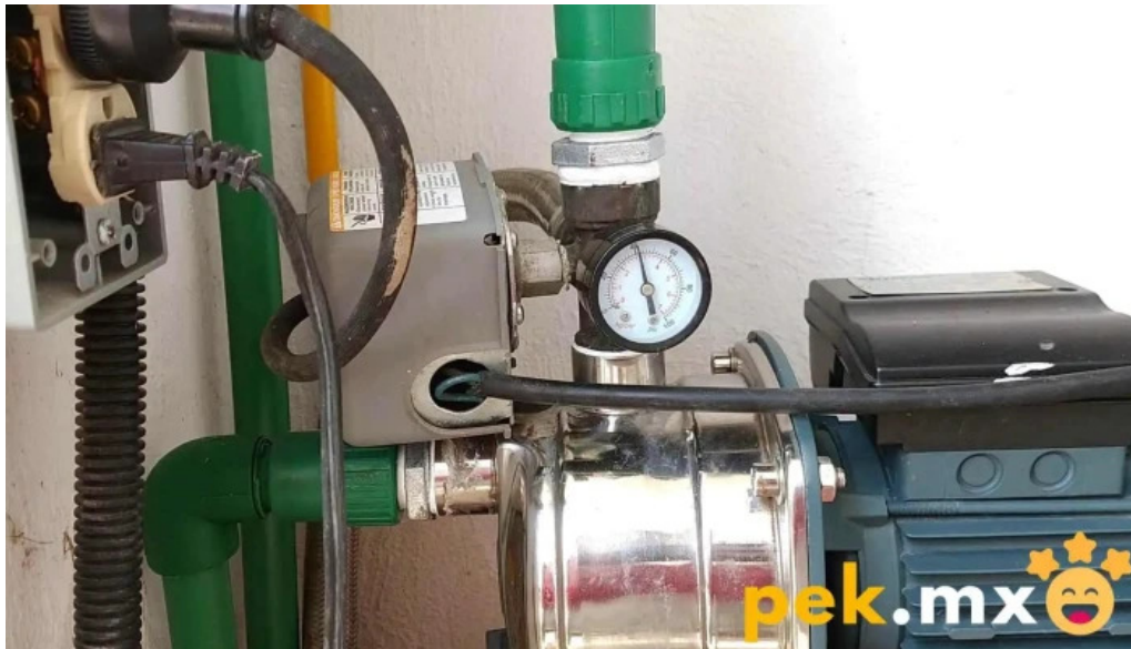
Plomero fontanero electricidad jp tuberia
