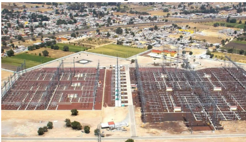
Subestacion electrica teotihuacan zona de transmision metropolitana san lorenzo talmimilolpan
