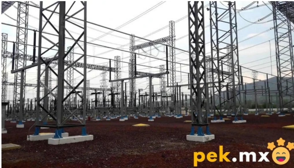
Subestacion electrica teotihuacan zona de transmision metropolitana puntaje
