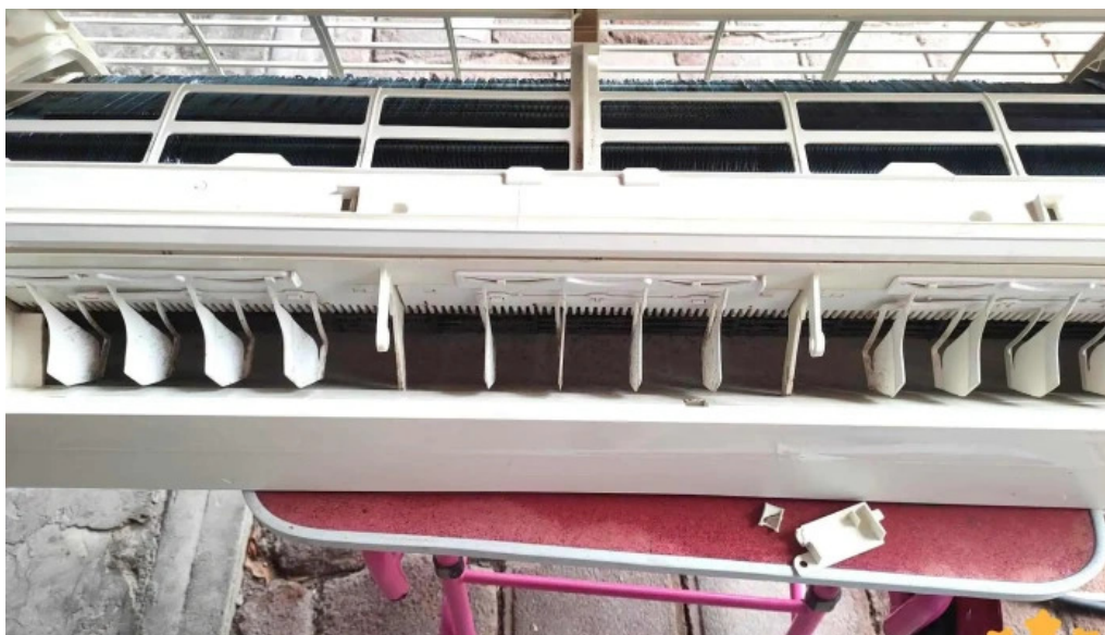
Taller de aires acondicionados y electrico saam del propietario
