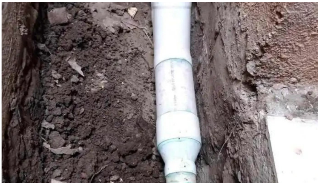
Plomeria y electricidad electro gil gustavo a madero ciudad de mexico
