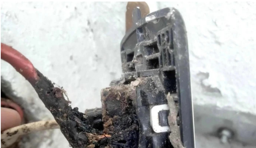
Multiservicios electricidad metepec san salvador tizatlalli
