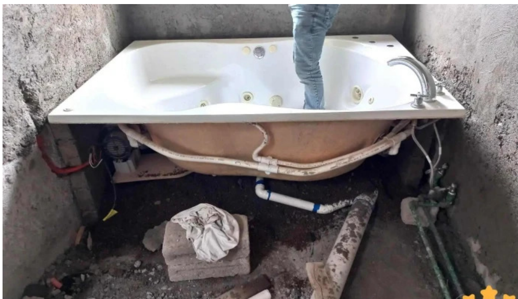
Multiservicios electricidad metepec bano
