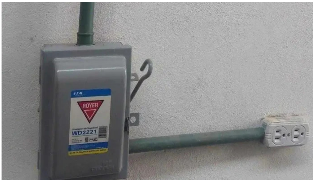
Instalaciones electricas lozano ciudad de mexico
