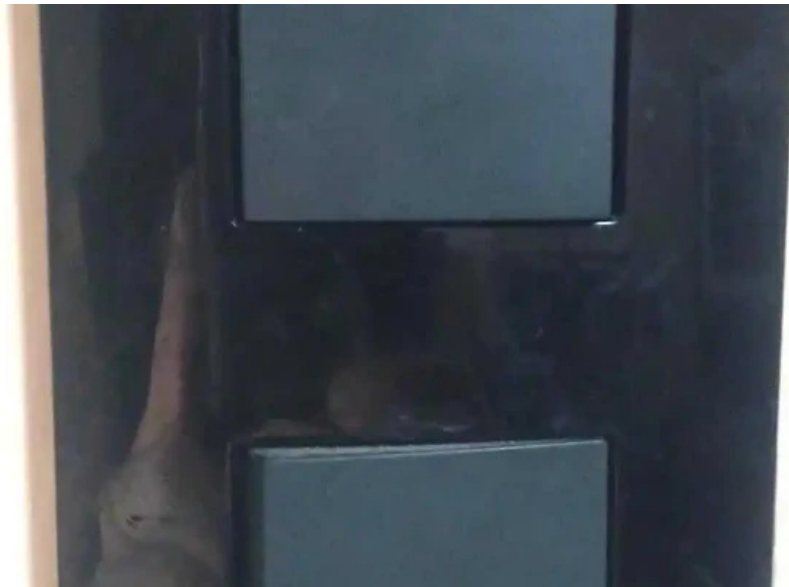
Instalaciones electricas lozano del propietario
