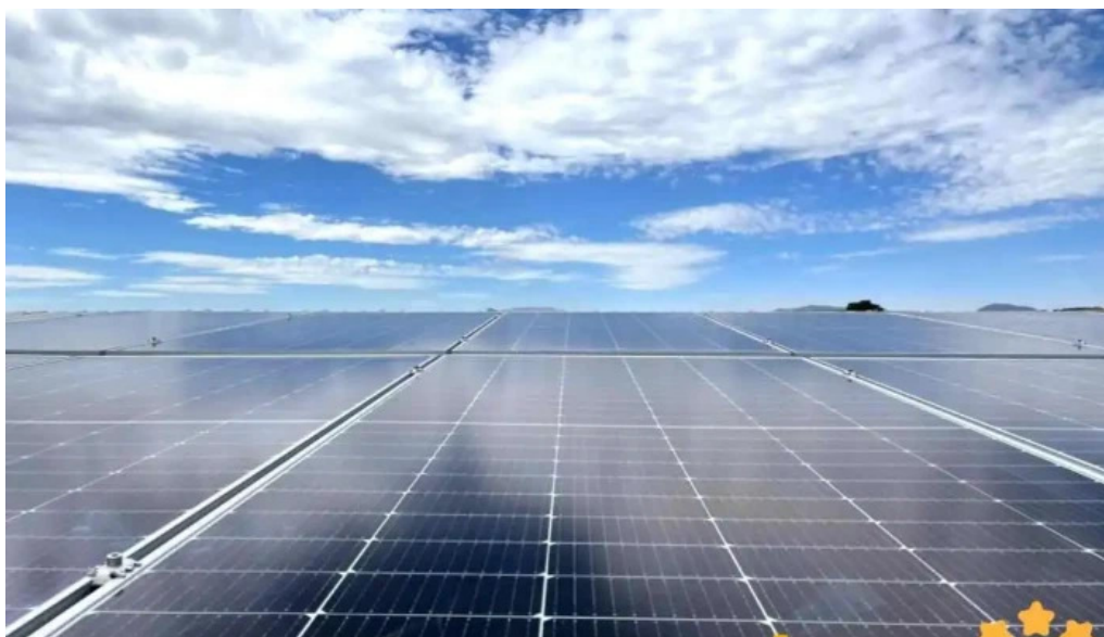
Runisun paneles solares del propietario
