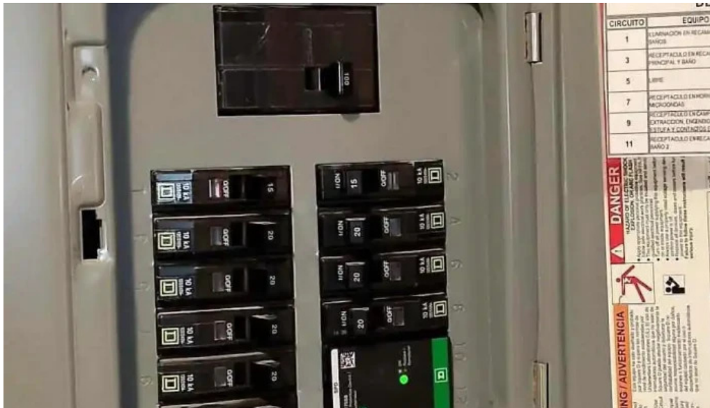
Instalaciones electricas de interfonos y mantenimiento general del propietario
