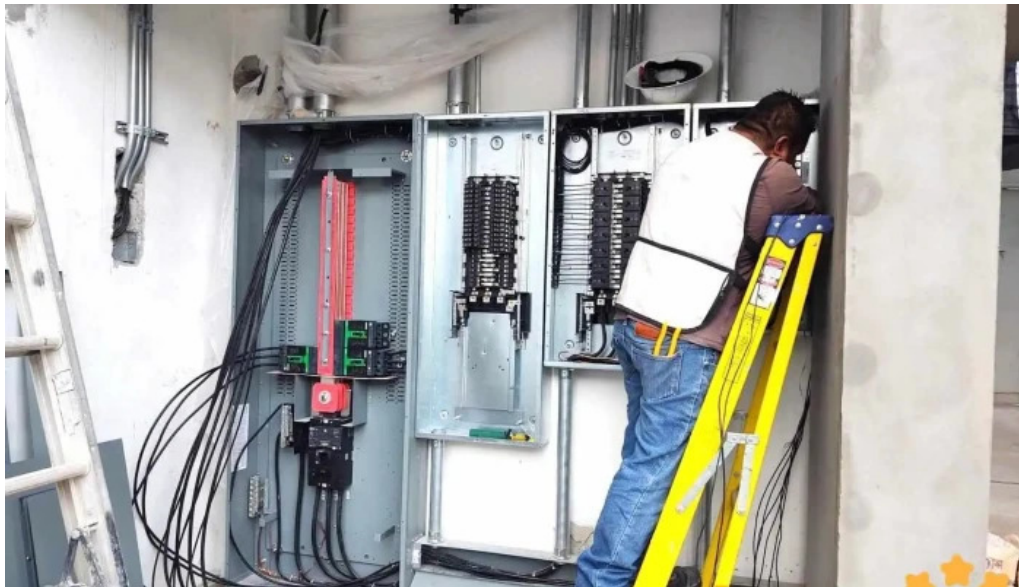
Cmt instalaciones electricas promocion
