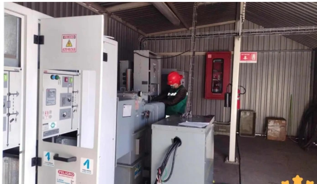
Telesma sistemas electricos sa de cv interior
