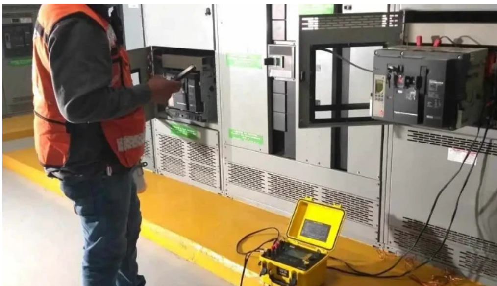
Switch control del propietario
