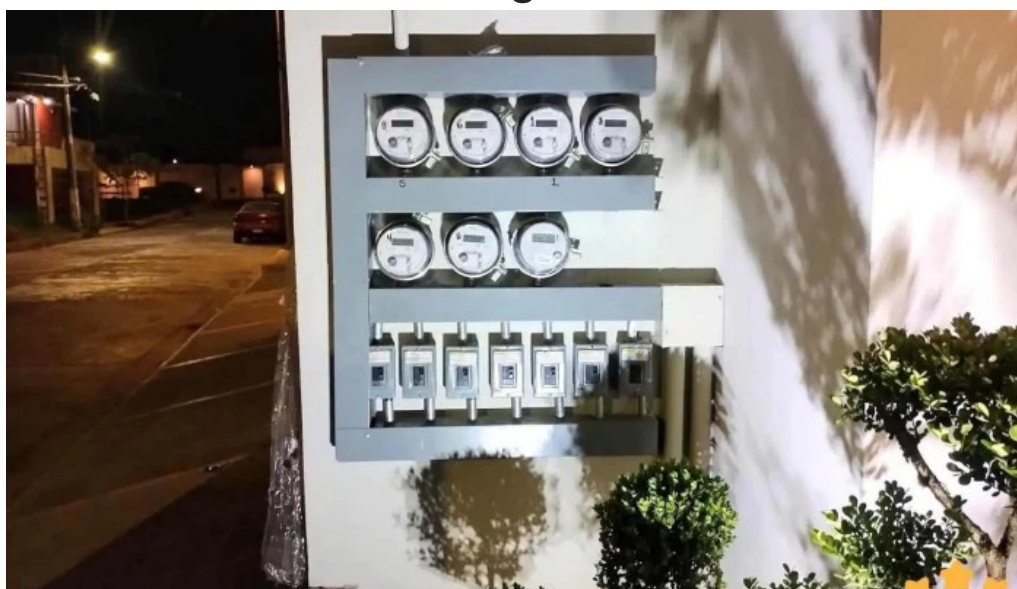
Dyza® electricidad santa martina
