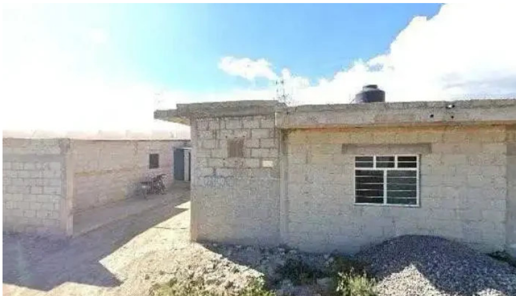
Balconeria e instalaciones electricas cano numero
