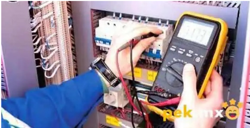
Instalaciones electricas casa habitacion del propietario
