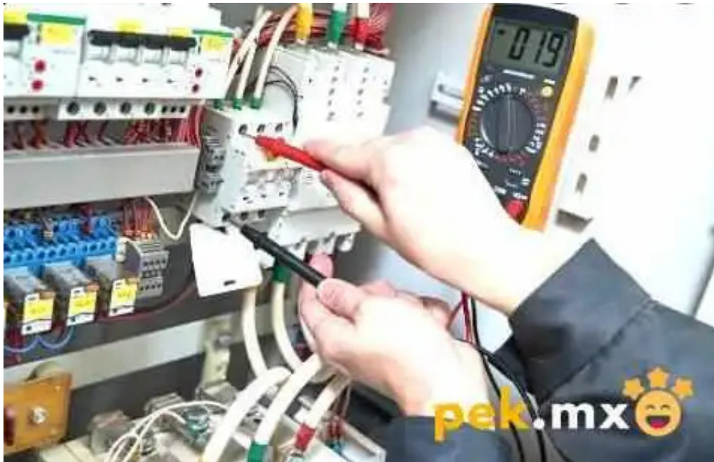
Instalaciones electricas casa habitacion tlahuac ciudad de mexico
