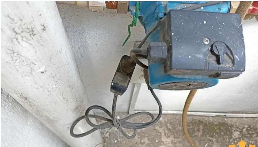
Plomeriay electricidad ramos toluca de lerdo
