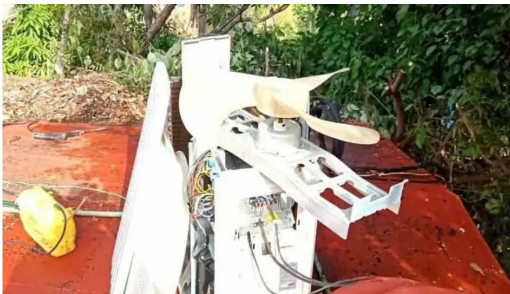
Taller de refrigeracion y aire acondicionado electricidad electrodomesticos el venado
