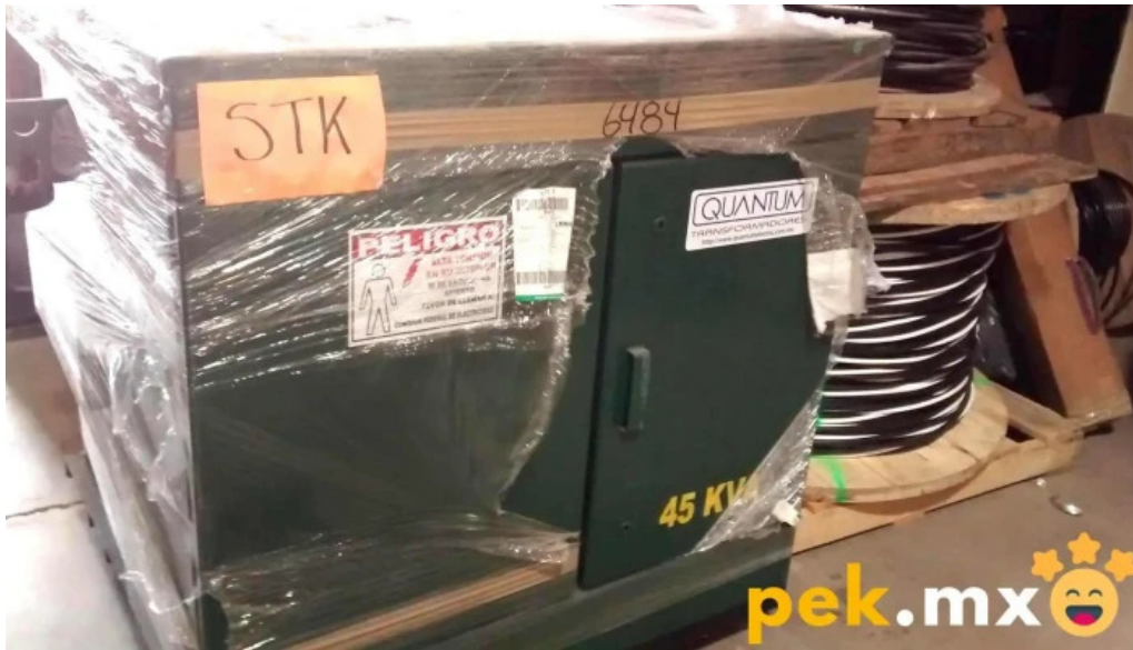
Transformadores y cables electricos rocha interior
