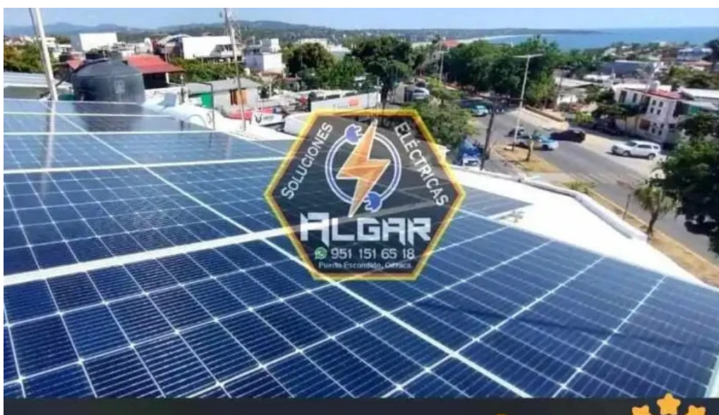
Paneles solares y soluciones electricas algar puntaje
